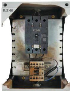
Figura C. Después de la prueba del interruptor
